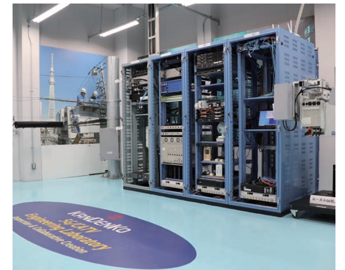
「ローカル5Gラボ」内に設置された、コアサーバー等を収納するラック
