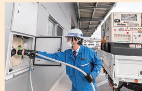
BCP用接続盤と非常用発電機の接続訓練
