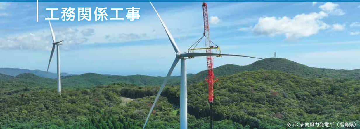
あぶくま南風力発電所（福島県）
