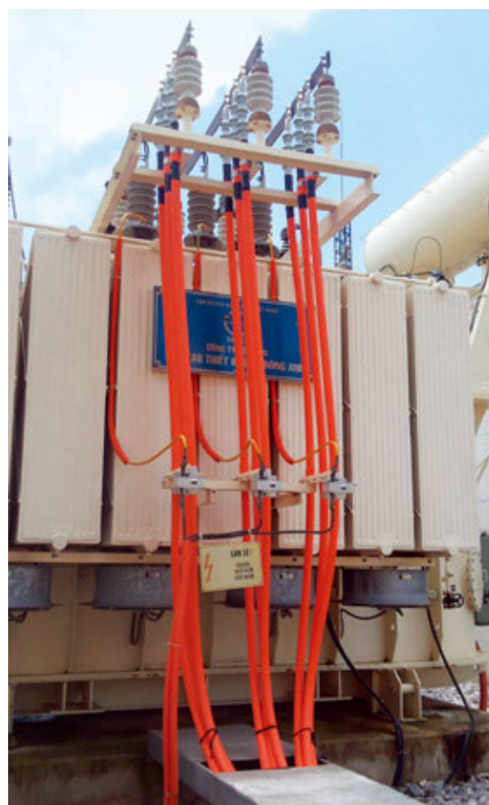
▲ 工業団地の電源となる変圧器
