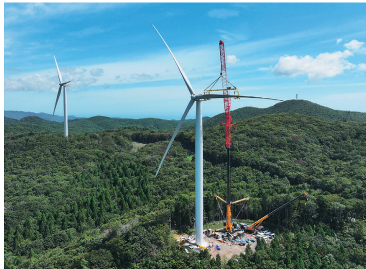
あぶくま南風力発電所（福島県）
